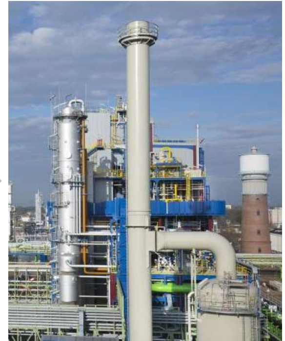
Bayer MaterialScience: Neue TDI-Anlage in Dormagen eröffnet (plasticker.de)
